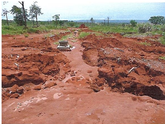
Fig. 6: Ilustração da erosão provocada no setor pela ausência de drenagem (NCA, 2011).
