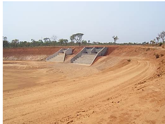
Fig. 7: Bacia de contenção, sem revestimento de proteção contra erosão (NCA, 2011).
